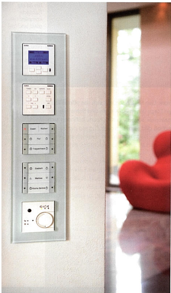
△ Bedient wird die Technik über Tastsensoren von Gira, hier im Schalterdesign Gira Esprit Glas Mint. Über ein Multiroom-System von Revox ist auch die Musiksteuerung integriert.
